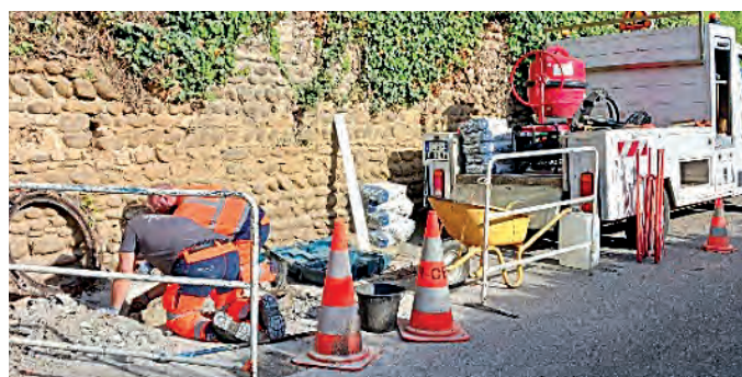
Remplacement d'une plaque d'égout volée
